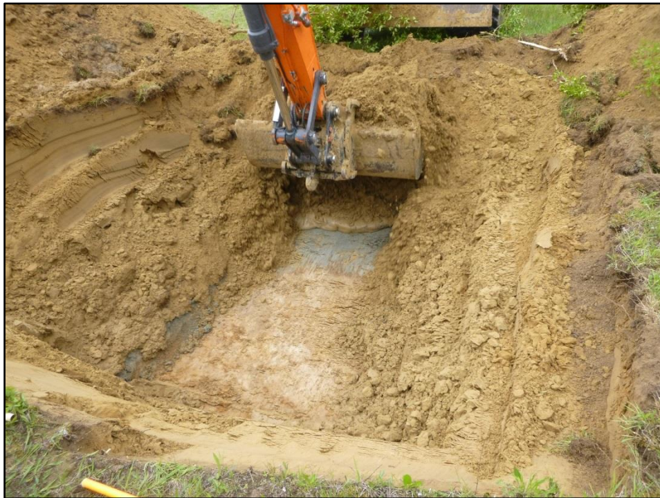
Figuur 87: overzichtsfoto van de onstabiele ophogingspakketten bij aanleg van één van de profielputten (ABO nv 2019)
