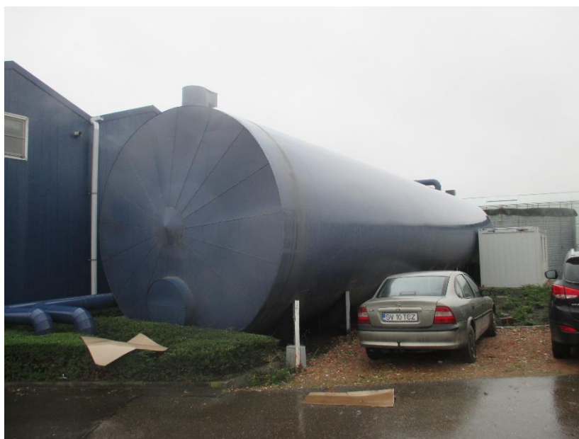
Figuur 7: Foto van een liggende warmteopslagtank 8
