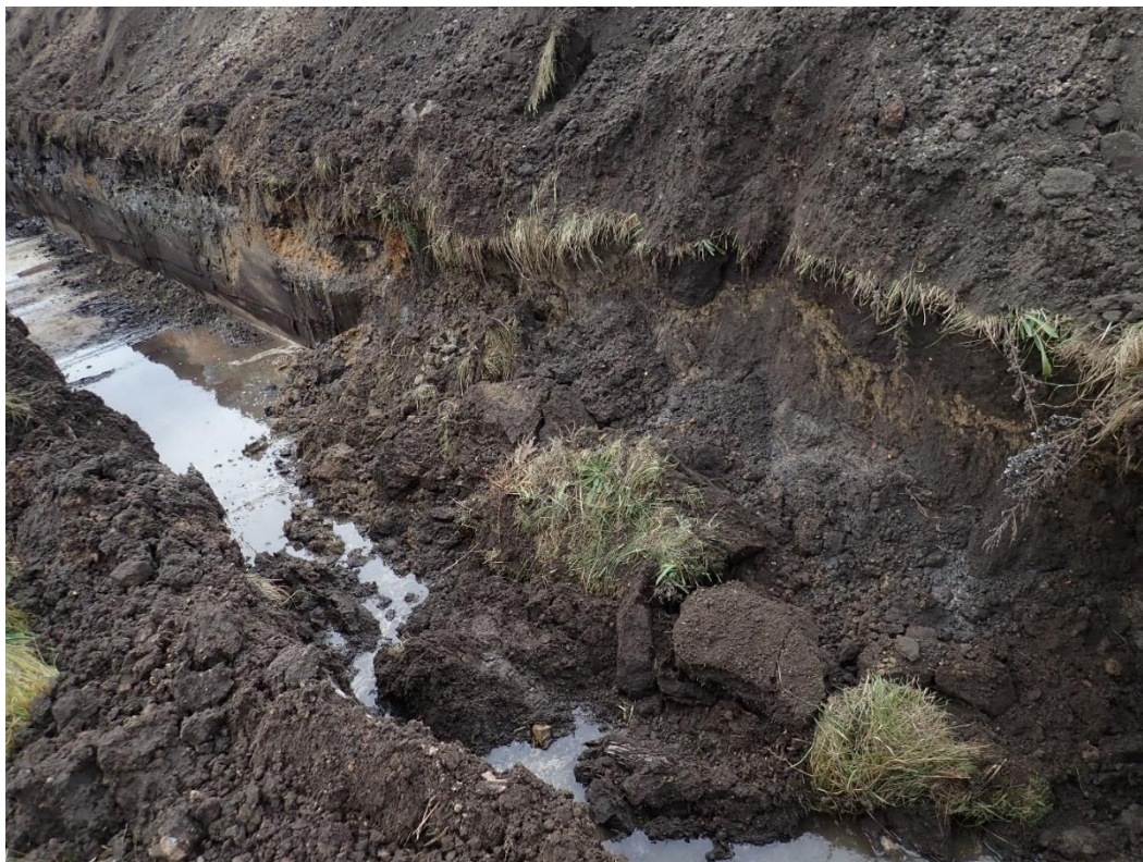
Figuur 20: Ingestorte werkput enkele ogenblikken na het aanleggen (© J. Verrijckt Bvba)
