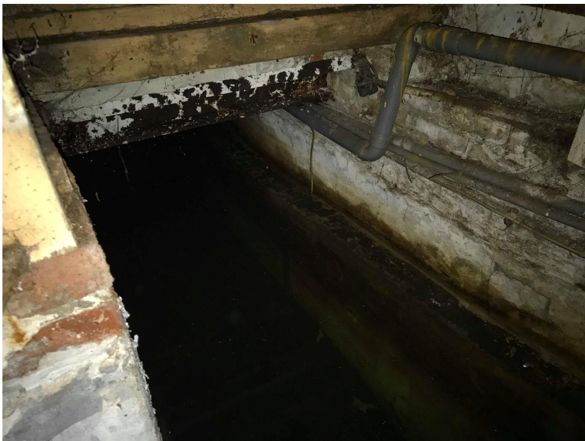
Figuur 10: Kelder met hierboven een trap. Kelder staat onder water 16
