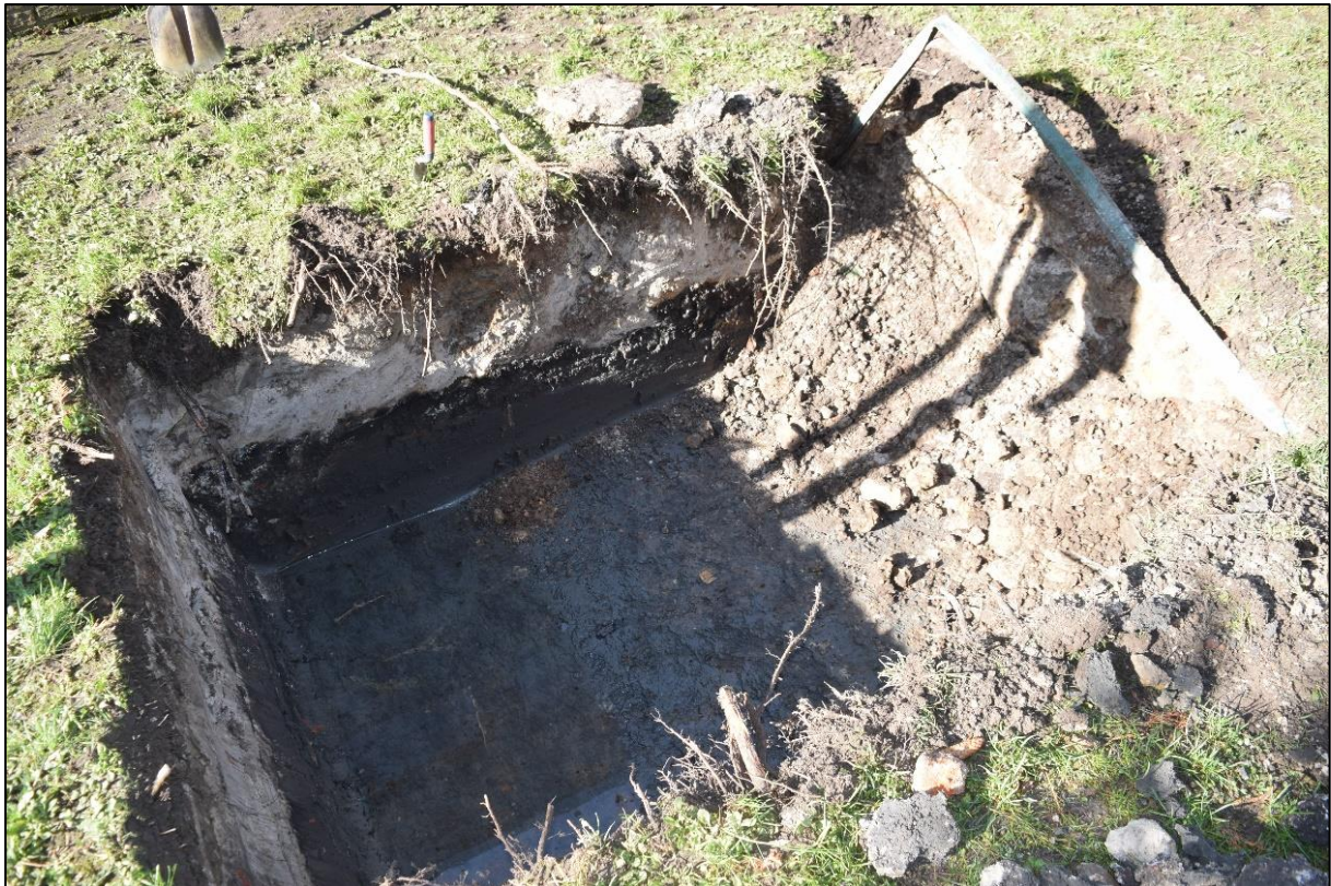
Afb. 51: Proefput 1, aangesneden elektriciteitsleiding.
