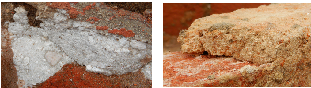
Figuur 21. De mortel van de schouwfundering (links) en de mortel van de beerputfundering (rechts).
