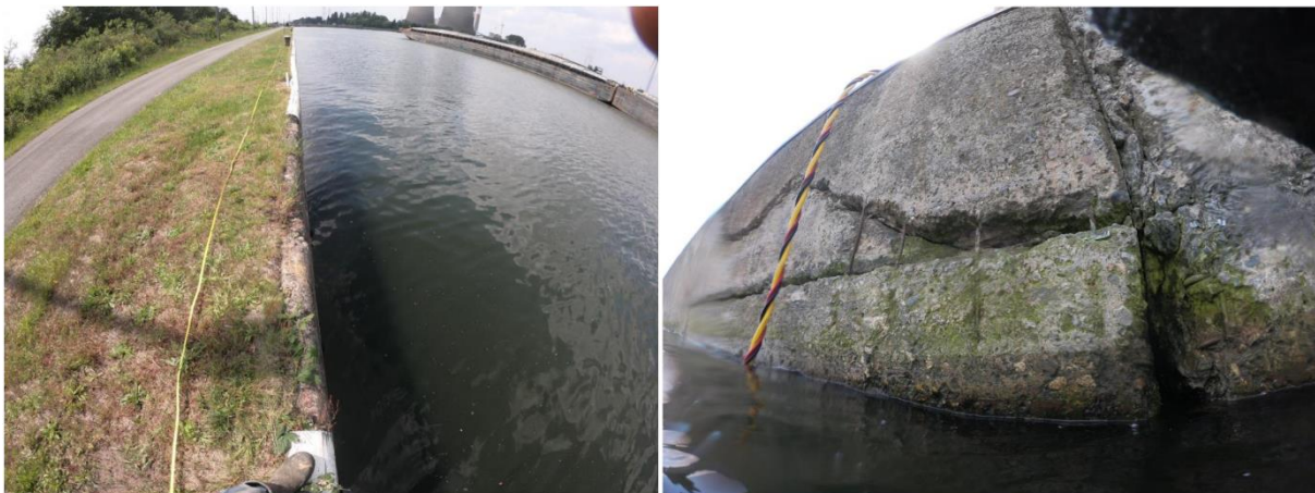
Figuur 1: Overzichtsfoto van de kesp (links) en detail van de kesp met schade aan kop balk met het zichtbare betonijzer.
