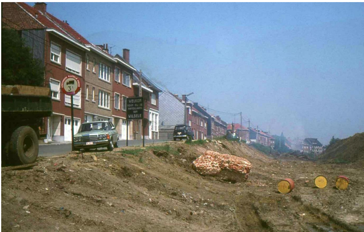
Figuur 10: Grondvesten van de omwalling worden blootgelegd bij ringwerken ter hoogte van Albert Wouterstraat (richting kanaal) 36
