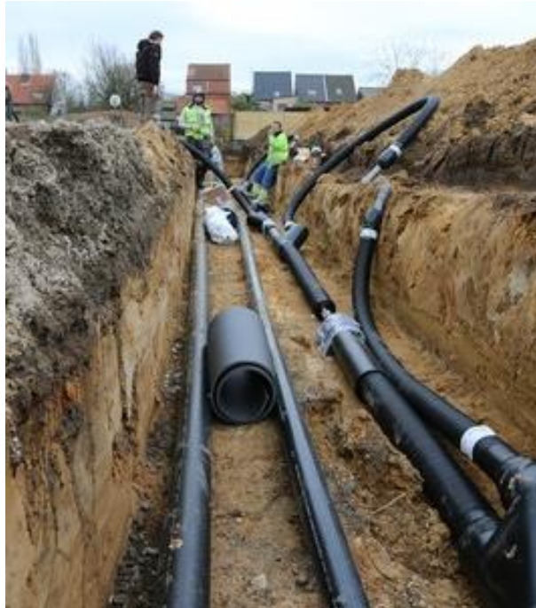
Figuur 4. De impact van een BEO-veld op de ondergrond is erg intensief doordat de boorgaten onderling verbonden worden door brede sleuven.
