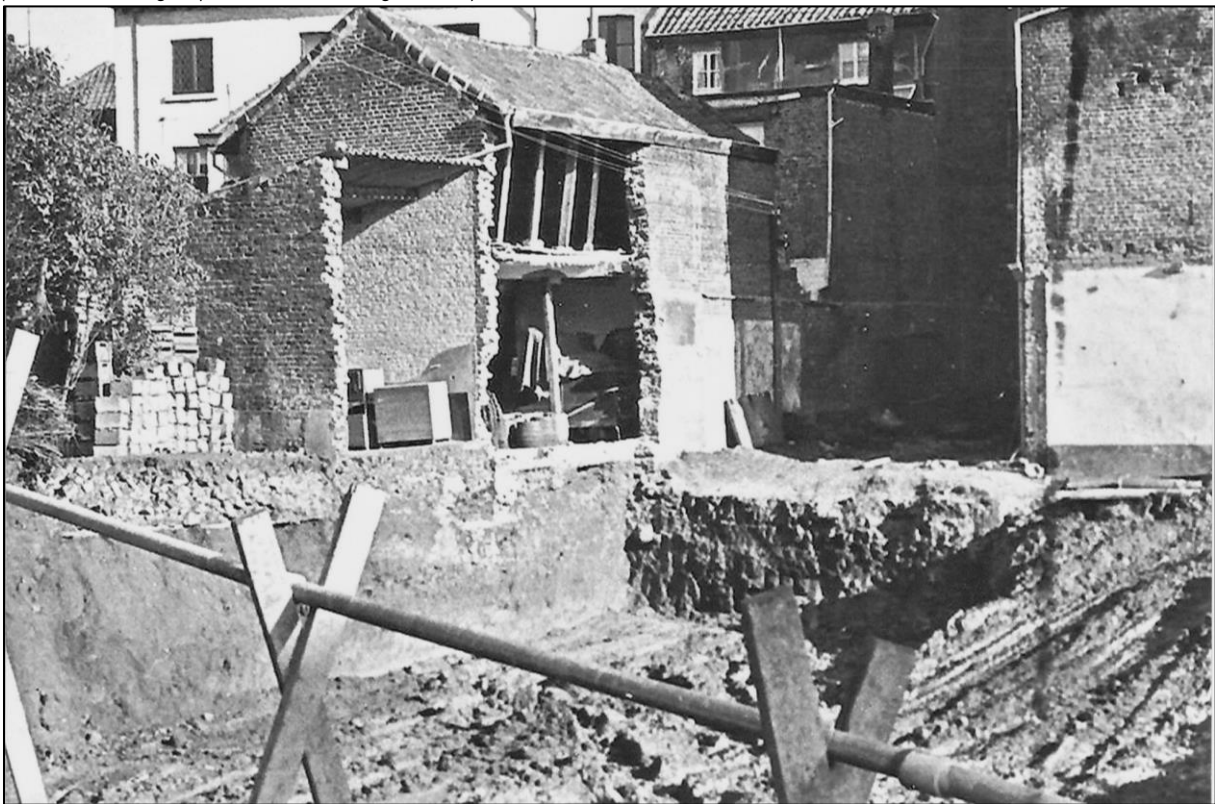
Afb. 38: Graven van de funderingen van het tweede gedeelte van de nieuwbouw, begin jaren '60 20 ste eeuw (Bron: Facebookgroep Sint-Trudo instituut – De Broeders).
