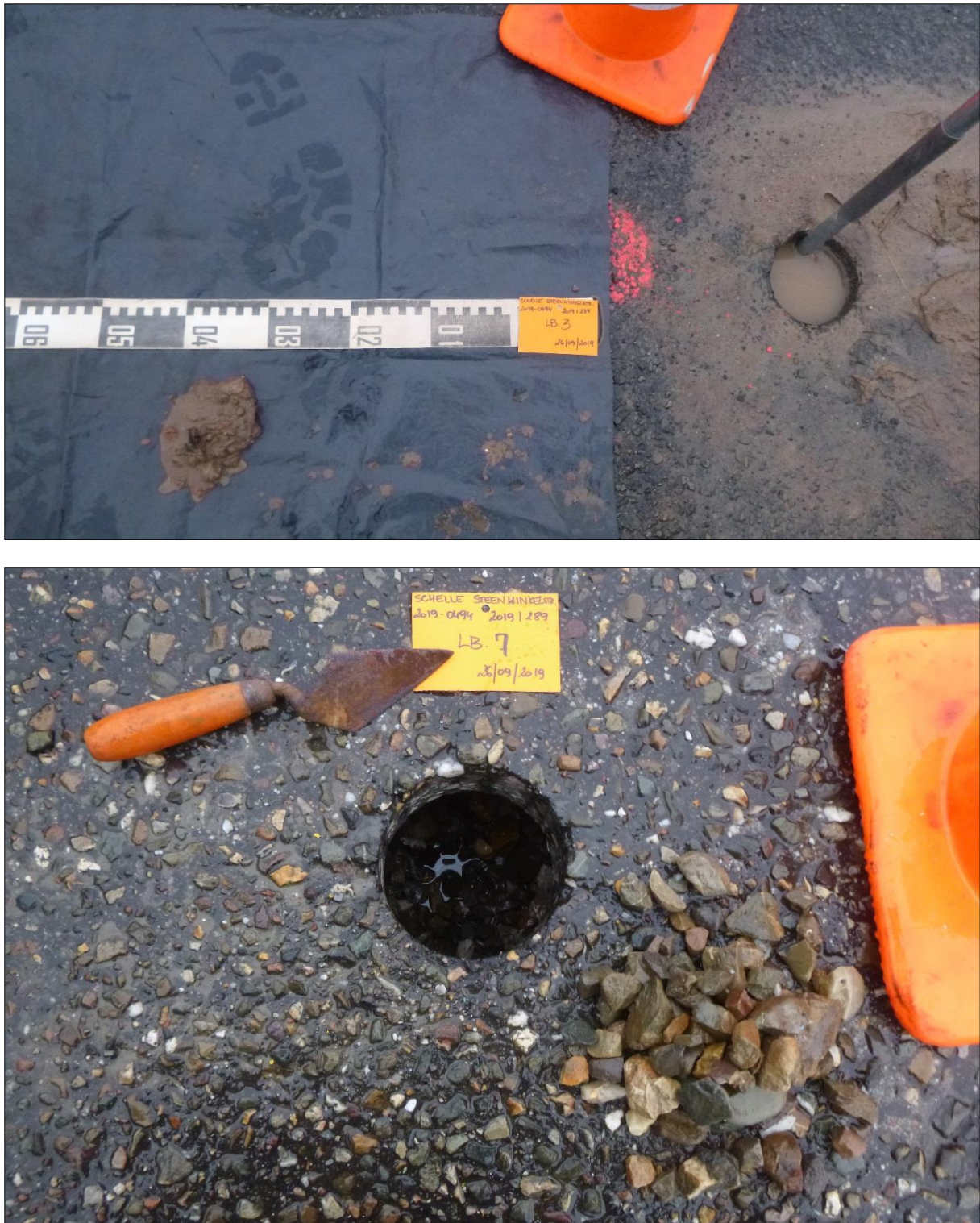
Figuur 7: Voorbeelden van met water en losse stenen opgevulde boorgaten – boring 3 (boven) en boring 7 (beneden). De datum op de boorkaartjes is verkeerd weergegeven. De boringen werden op 04.10.2019 uitgevoerd.
