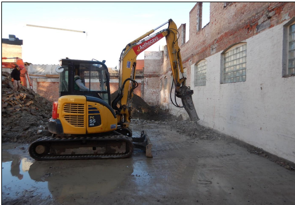
Figuur 5 Uitschieten van de betonplaat.
