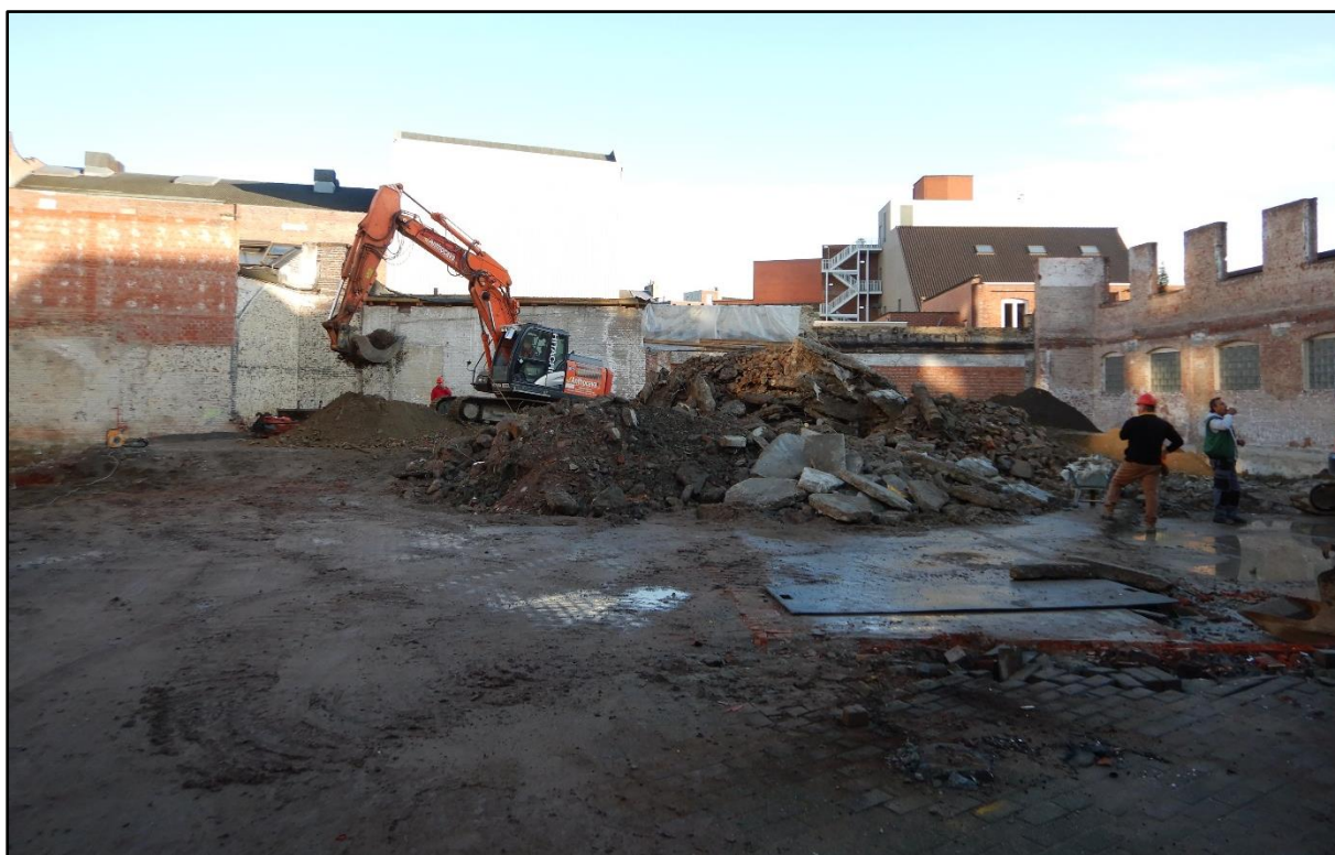
Figuur 4 Uitbreken van de betonverhardingen op maaiveldniveau.
