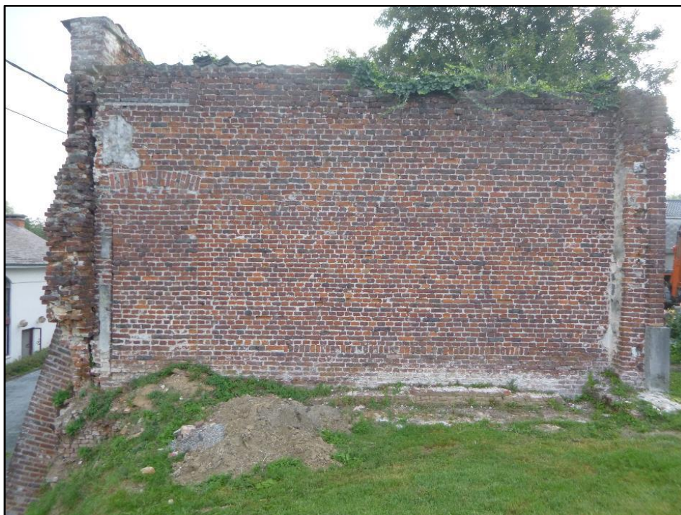
Figuur 22: Algemeen zicht op de westzijde van de westelijke gevel met dichtgemaakte deuropening (ABO nv 2019)
