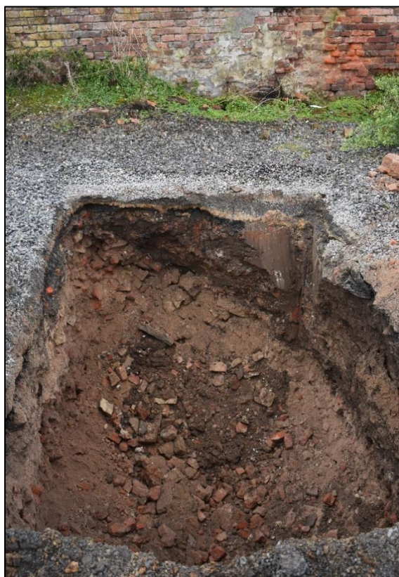
Afb.20 (links): PP1 met instortende profielwand (Bron: Aron bv)
