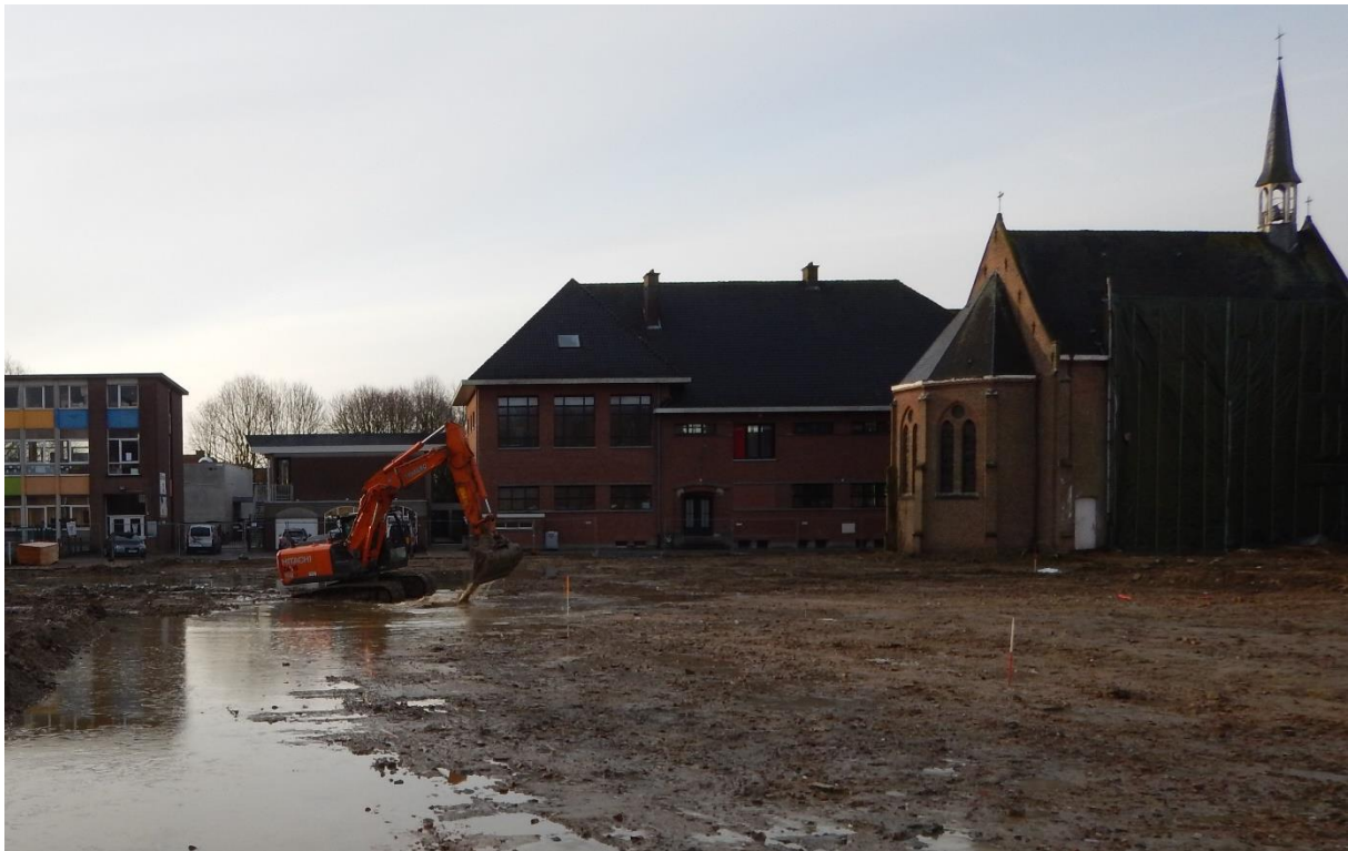
Figuur 3: De kraan wegzakkend in de modder ter hoogte van de locatie van een uitgebroken kelder.
