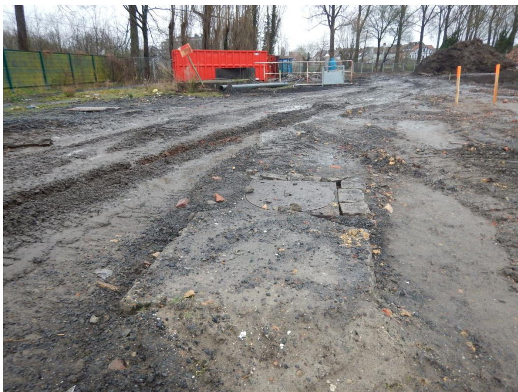
Figuur 5: Bovengrondse elementen van de riolering.
