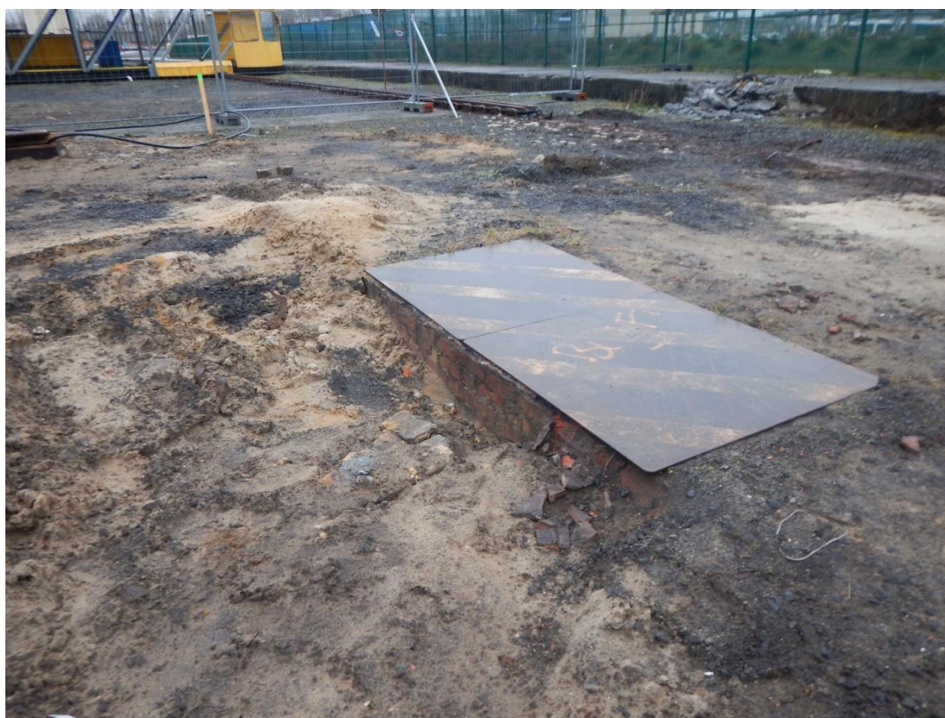
Figuur 4: Bovengrondse elementen van de riolering.
