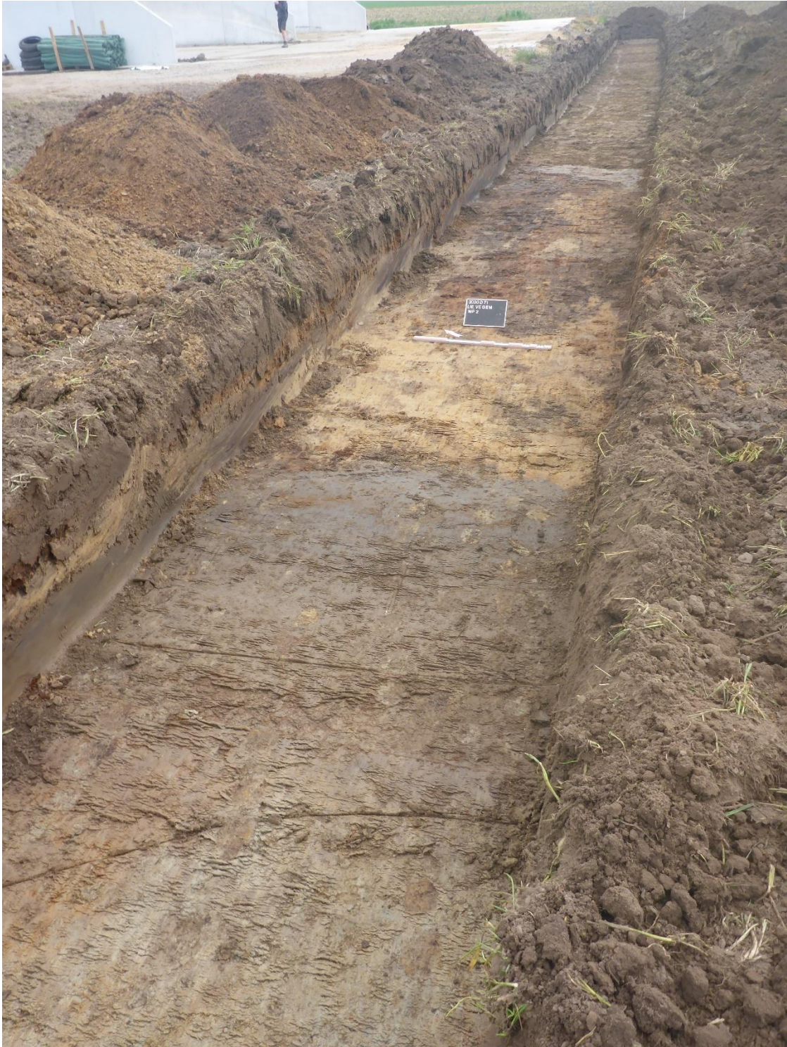
Figuur 46: Afbeelding van verstoring ter hoogte van werkput 2.
