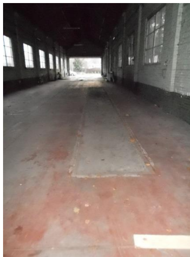
Figuur 4: De dichtgemaakte smeerput in loods De Lijn
