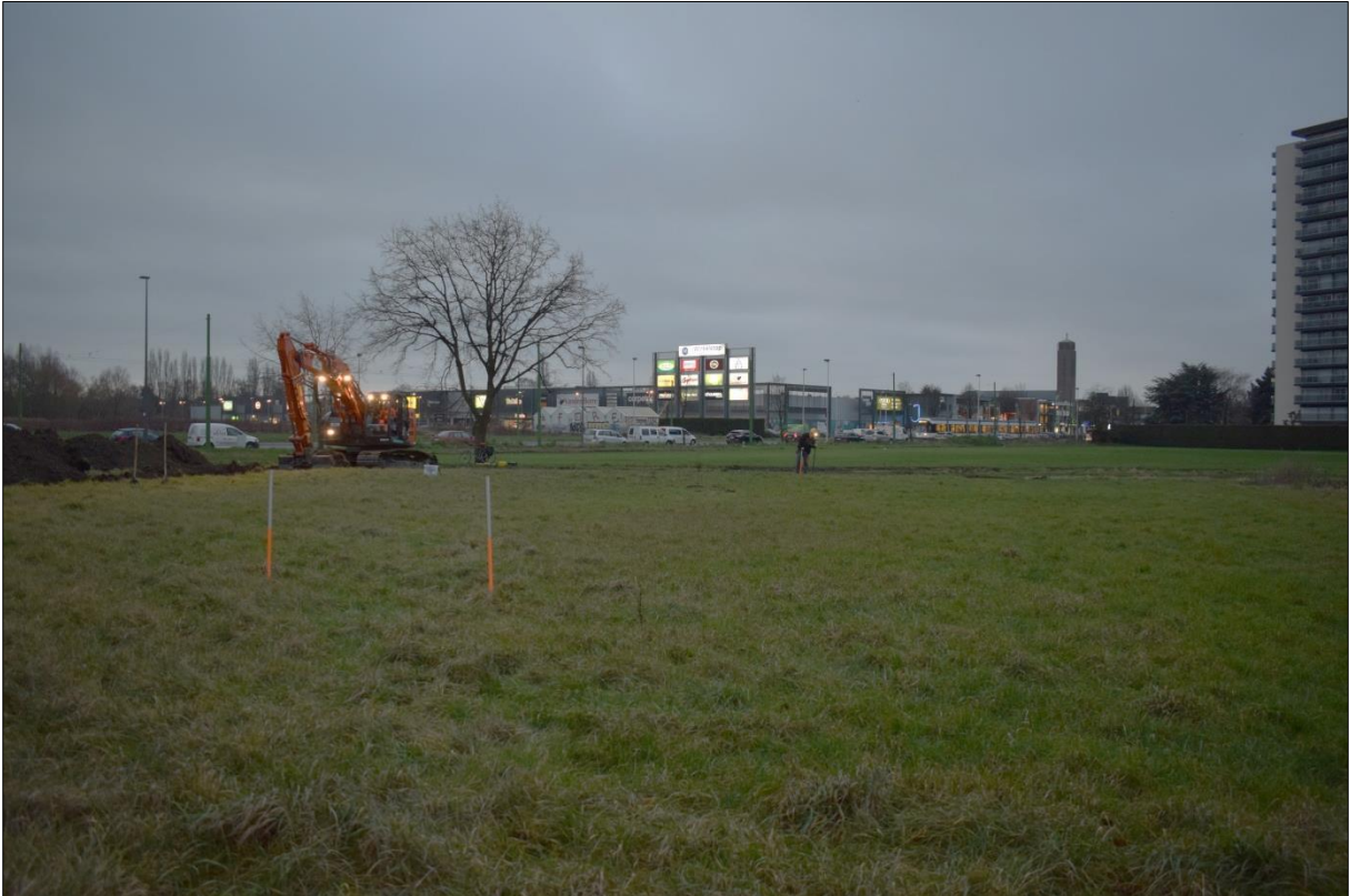
Figuur 4: Het projectgebied fase 1 (tijdelijke parking) tijdens het proefsleuvenonderzoek, zicht vanuit het noorden.
