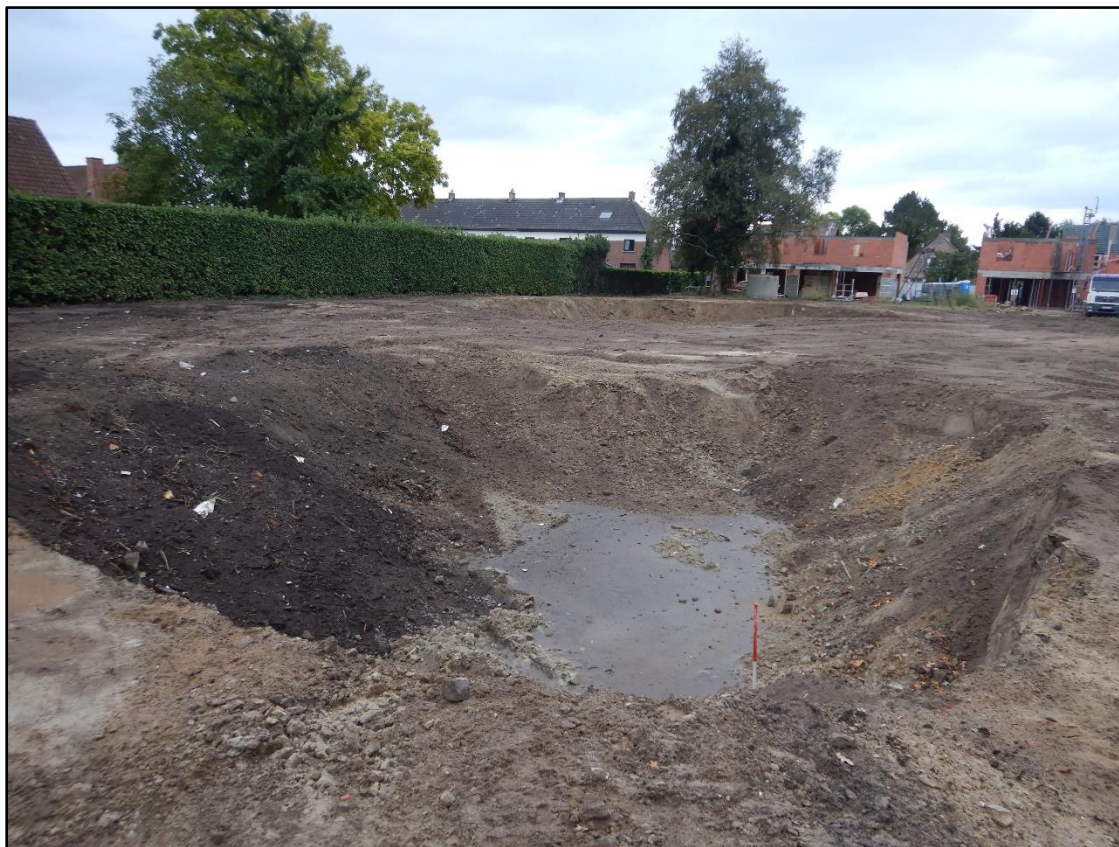
Figuur 4 De verstoring na het uitbreken van de kelder.
