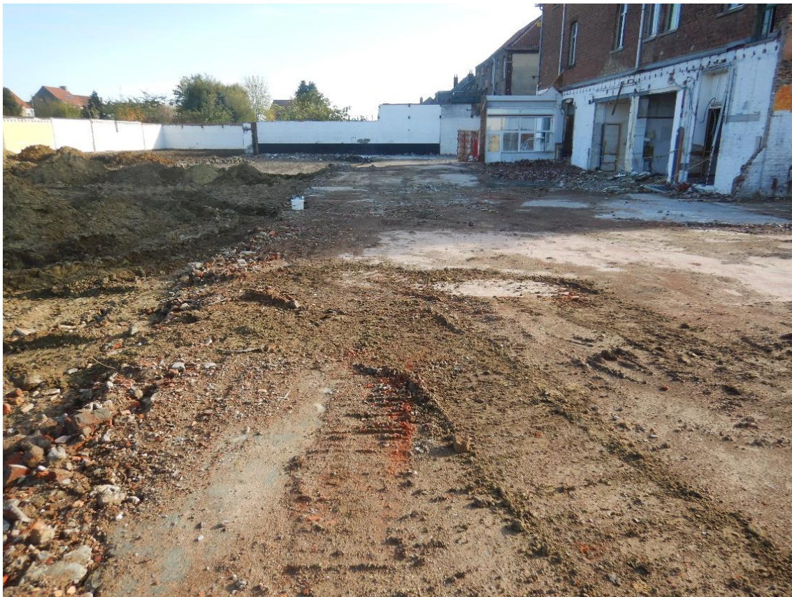
Figuur 6: Werkfoto niet verwijderde betonplaat
