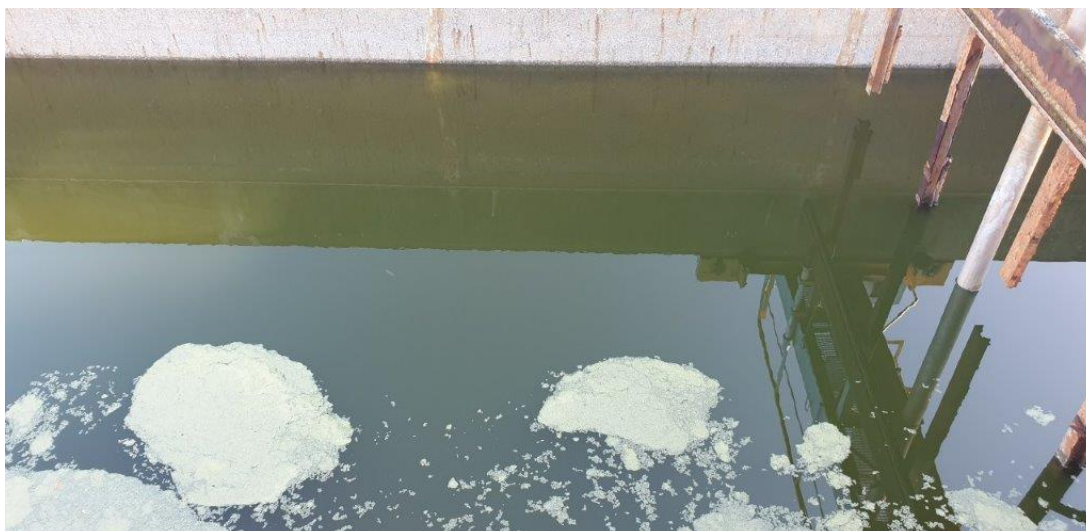
Figuur 19: Foto van waterzuiveringsinstallatie: detail 7 22
