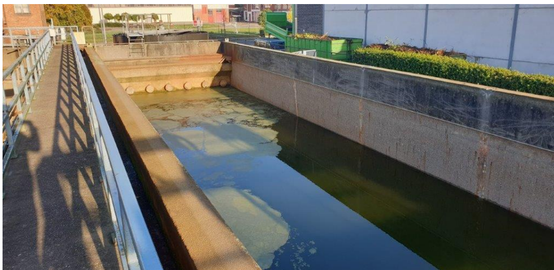
Figuur 13: Foto van waterzuiveringsinstallatie: detail 1 16
