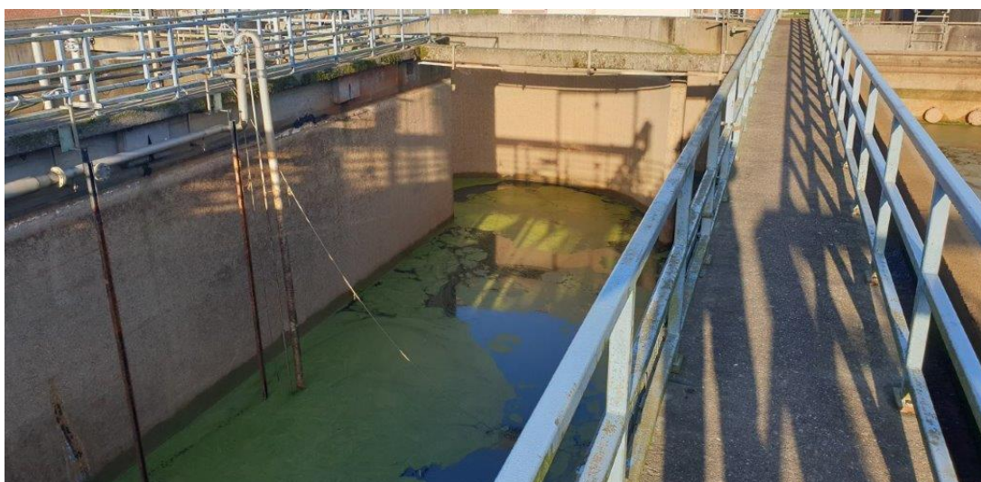
Figuur 14: Foto van waterzuiveringsinstallatie: detail 2 17
