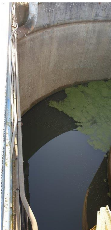
Figuur 15: Foto van waterzuiveringsinstallatie: detail 3 18
