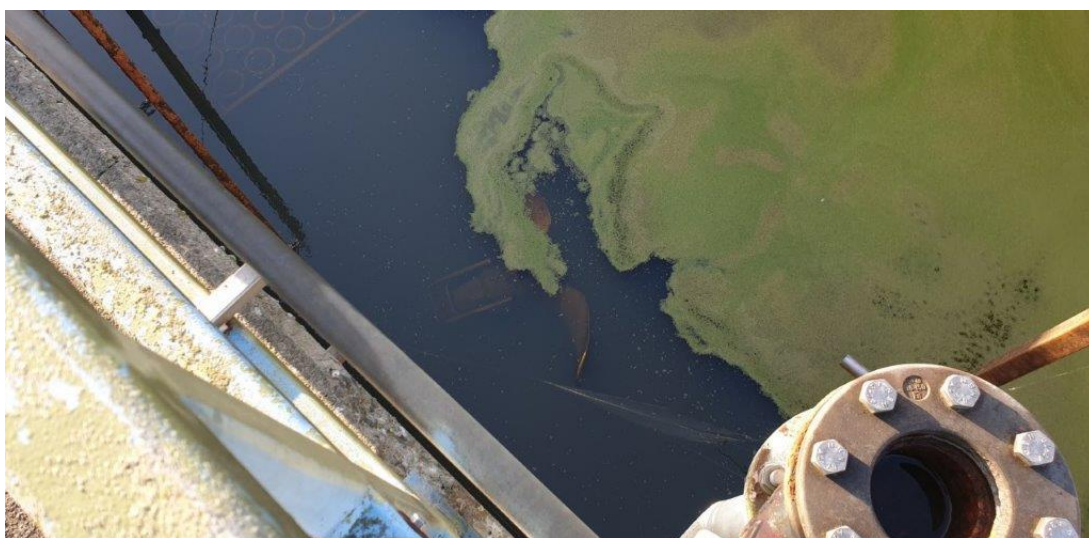
Figuur 18: Foto van waterzuiveringsinstallatie: detail 6 21
