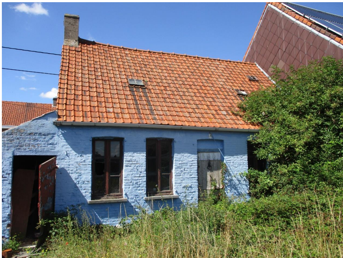
Figuur 7: Zicht op achtergevel van halfvrijstaande lage dorpswoning langs de Ingelmunstersteenweg (nr. 145) (Bron: opdrachtgever).
