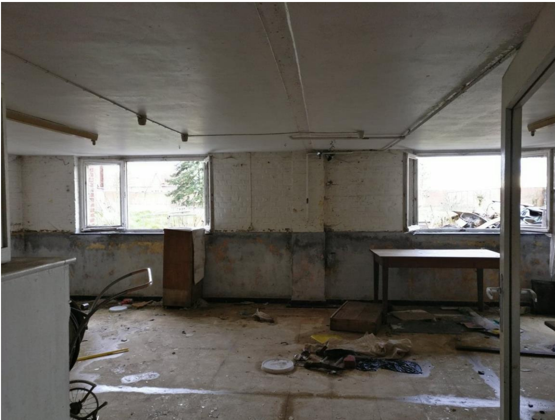
Figuur 14: Foto 1, het maaiveld ligt ter hoogte van de ramen.
