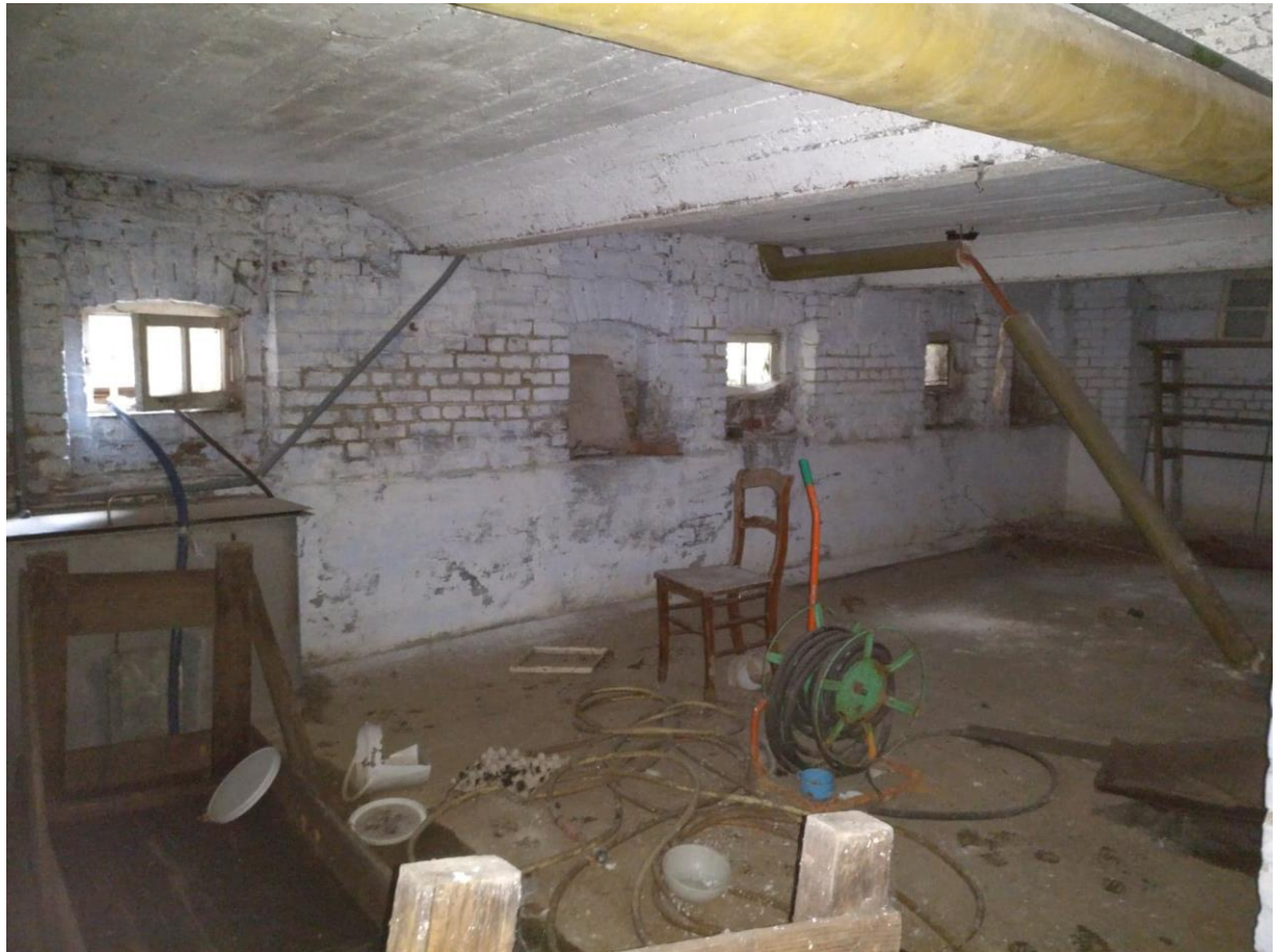
Figuur 15: Foto 2, het maaiveld ligt ter hoogte van de ramen.
