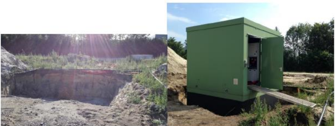
Figuur 6: Voorbeeld van netstation en elektriciteitscabine.
