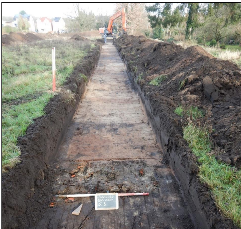
Figuur 24 Zicht op sleuf 3 in noordelijke richting. Op de voorgrond tekent zich een deel van de aangeboorde verstoring af.
