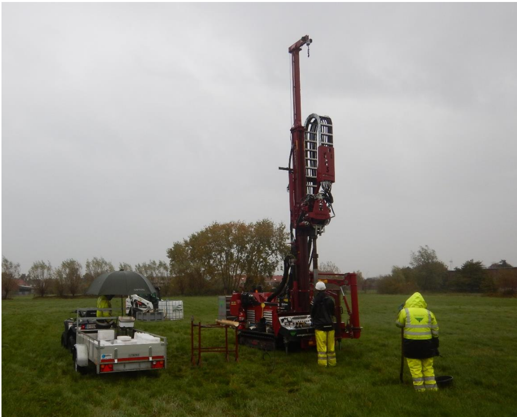
Figuur 44: Algemeen overzicht van de werkopstelling (GATE).
