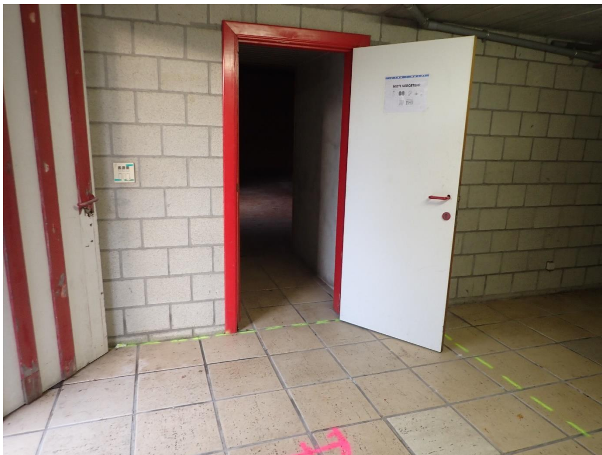
Figuur 4: Hinderlijke muur ter hoogte van Werkput 5
