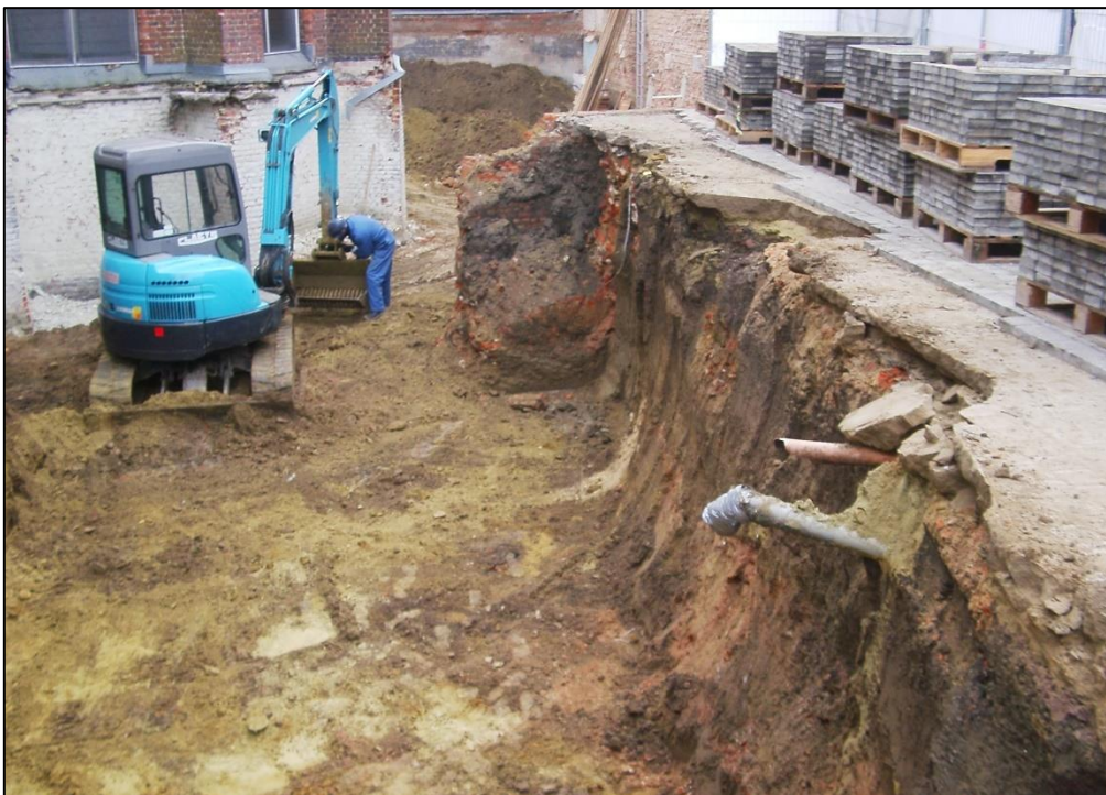
Figuur 1: Afgravingen in functie van de aanleg van de tunnel en aanpalende buitenruimte in 2008.
