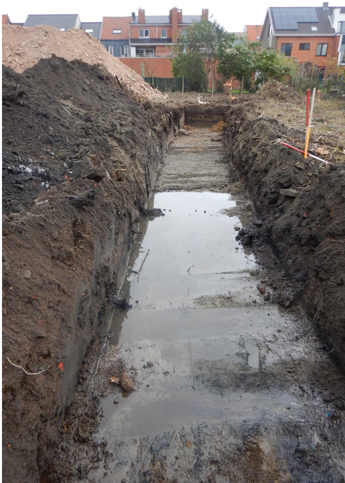
Figuur 32: De grijsblauwige verkleuring en natte omstandigheden ter hoogte van proefsleuf 7.
