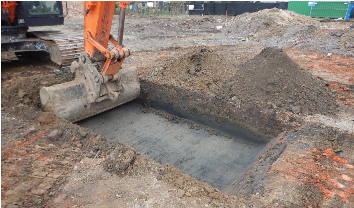
Figuur 30: De verkleurde ondergrond tijdens het afgraven van proefsleuf 5.
