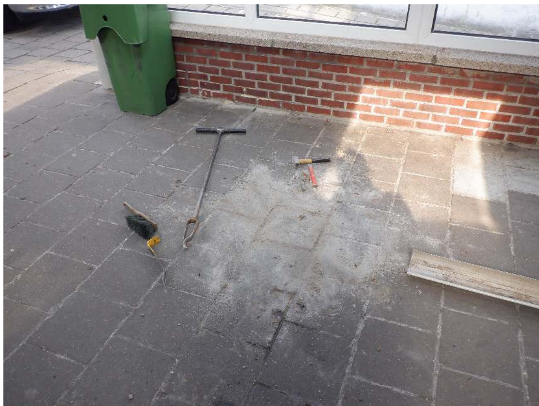
Afbeelding 3.4.6: Betontegels op de speelplaats werden na uitvoering opnieuw teruggelegd om ongelukken te vermijden.
