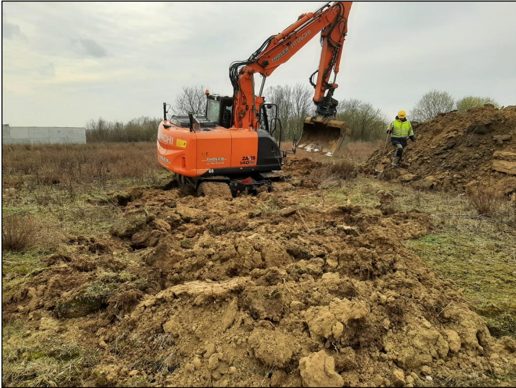
Figuur 3: Moeilijkheden op het terrein tijdens uitvoer nota Tongeren Carpoolparking (ID 18399): de kraan zakte weg ter hoogte van aan te leggen proefsleuf
