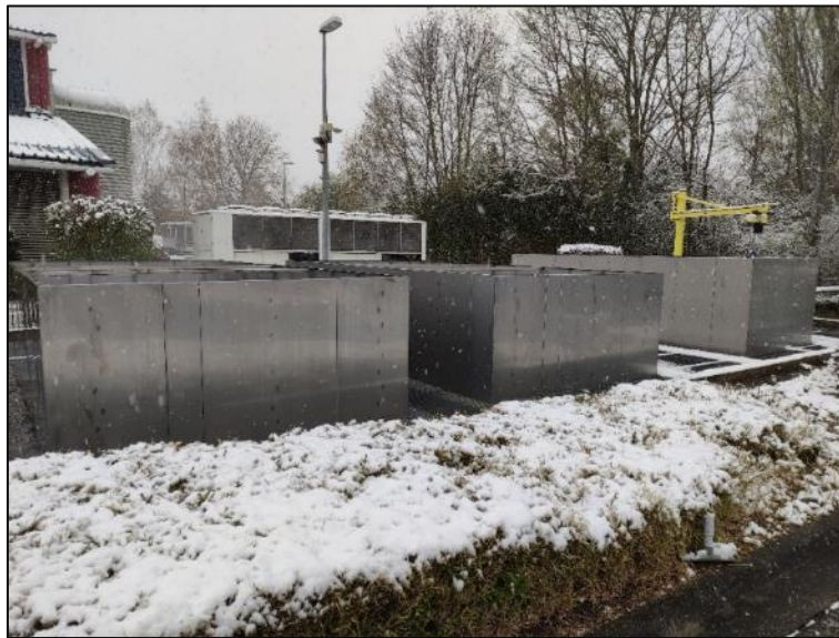
Figuur 7: Bestaande koelingsinstallaties (Initiatiefnemer 2021)
