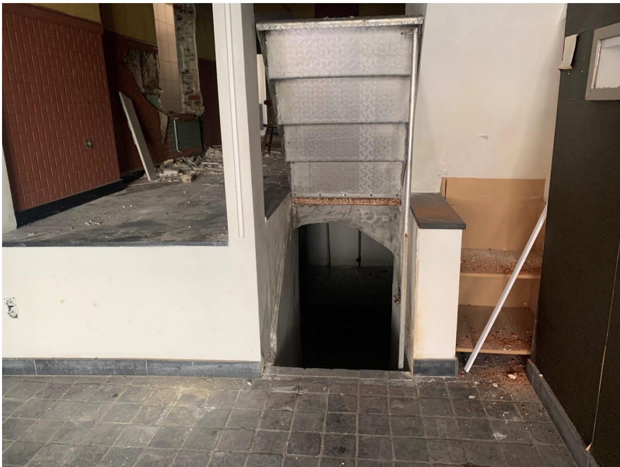
Figuur 2: Ingang kelder ter hoogte van huisnummer 23. 10
