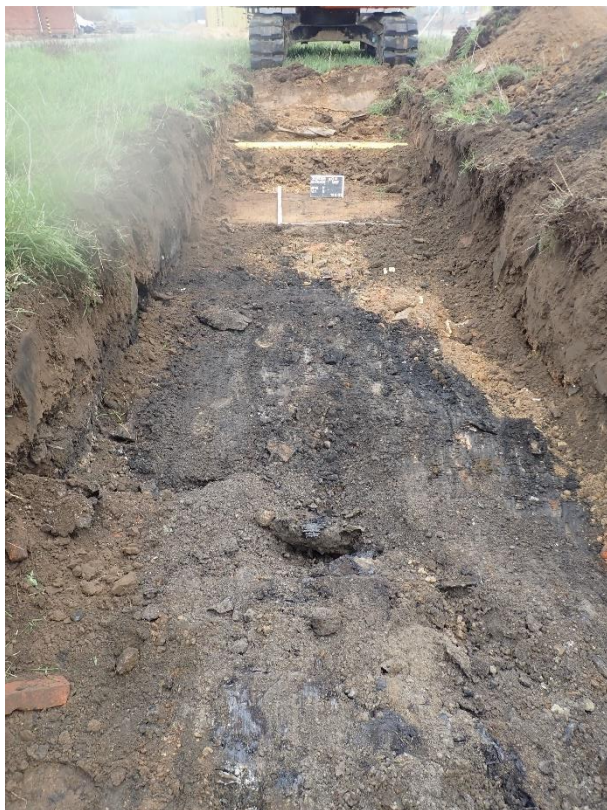
Figuur 46: Zicht op een gasleiding (© J. Verrijckt Bvba).
