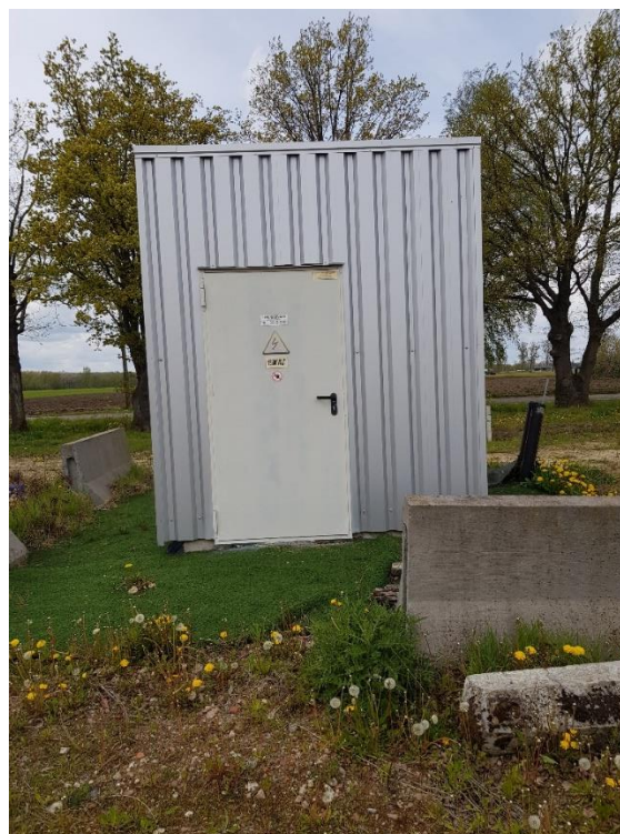
Figuur 11. Elektrischeitskabine in zuidwestelijke hoek onderzoeksgebied.
