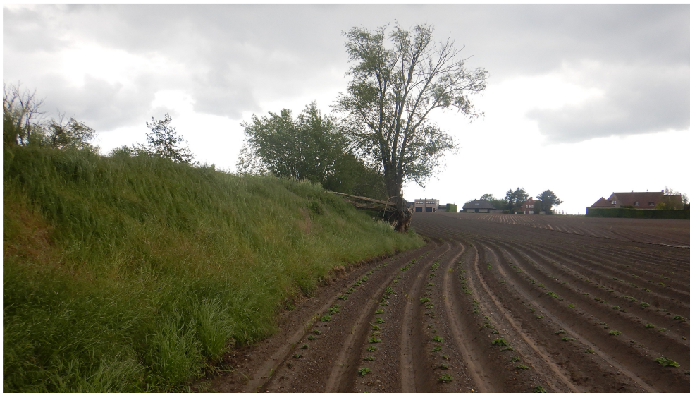
Figuur 7. Zicht op de plaats waar de beek overgaat in het belendende akkerland, waar de beek ingebuisd is. Bemerk de ophoging.
