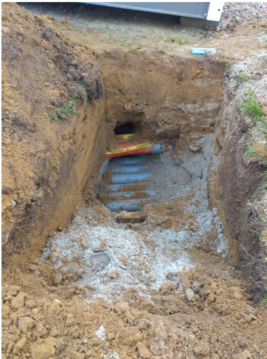
Figuur 4: Foto aanwezige leidingen binnen het onderzoeksgebied
