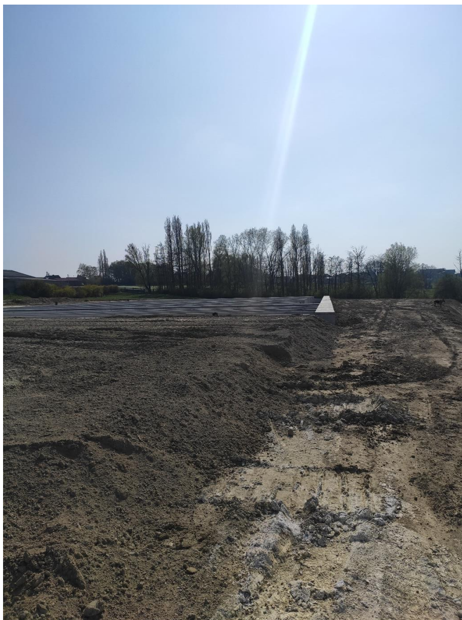
Figuur 14: foto vanop ophoging met zicht op kelder en opgehoogd deel dat moet verwijderd worden (rechts)
