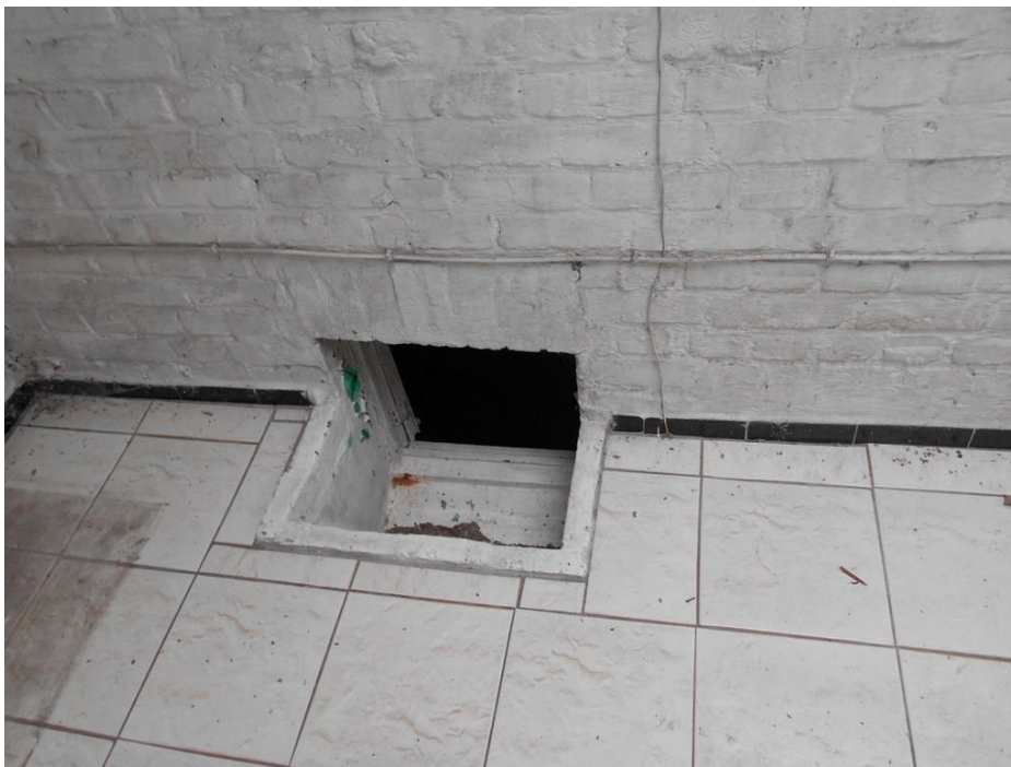
Figuur 2: Keldergat ter hoogte van huisnummer 70 in nieuwe zone 4. 21
