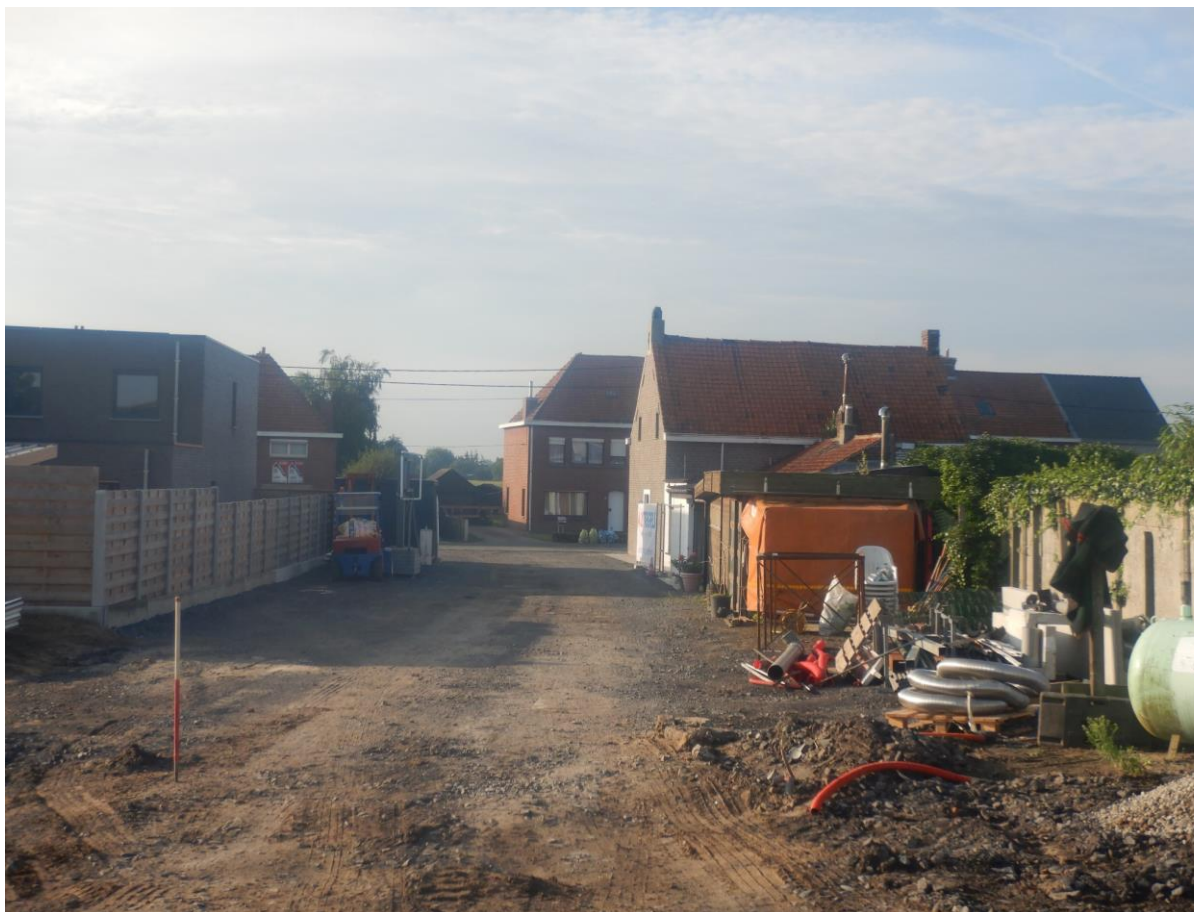
Figuur 8: Zicht op het zuiden van het plangebied met o.a. de elektriciteitscabine links.
