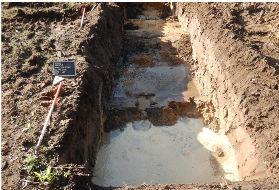
Figuur 21: Werkput 2, beschadigde waterafvoer ter hoogte van verstoring S7
