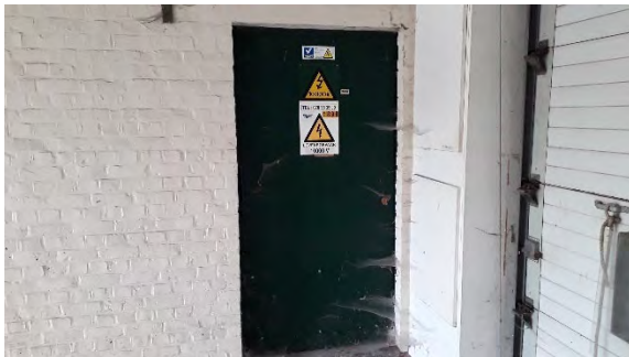
Hoogspanningscabine in gebouw B2
