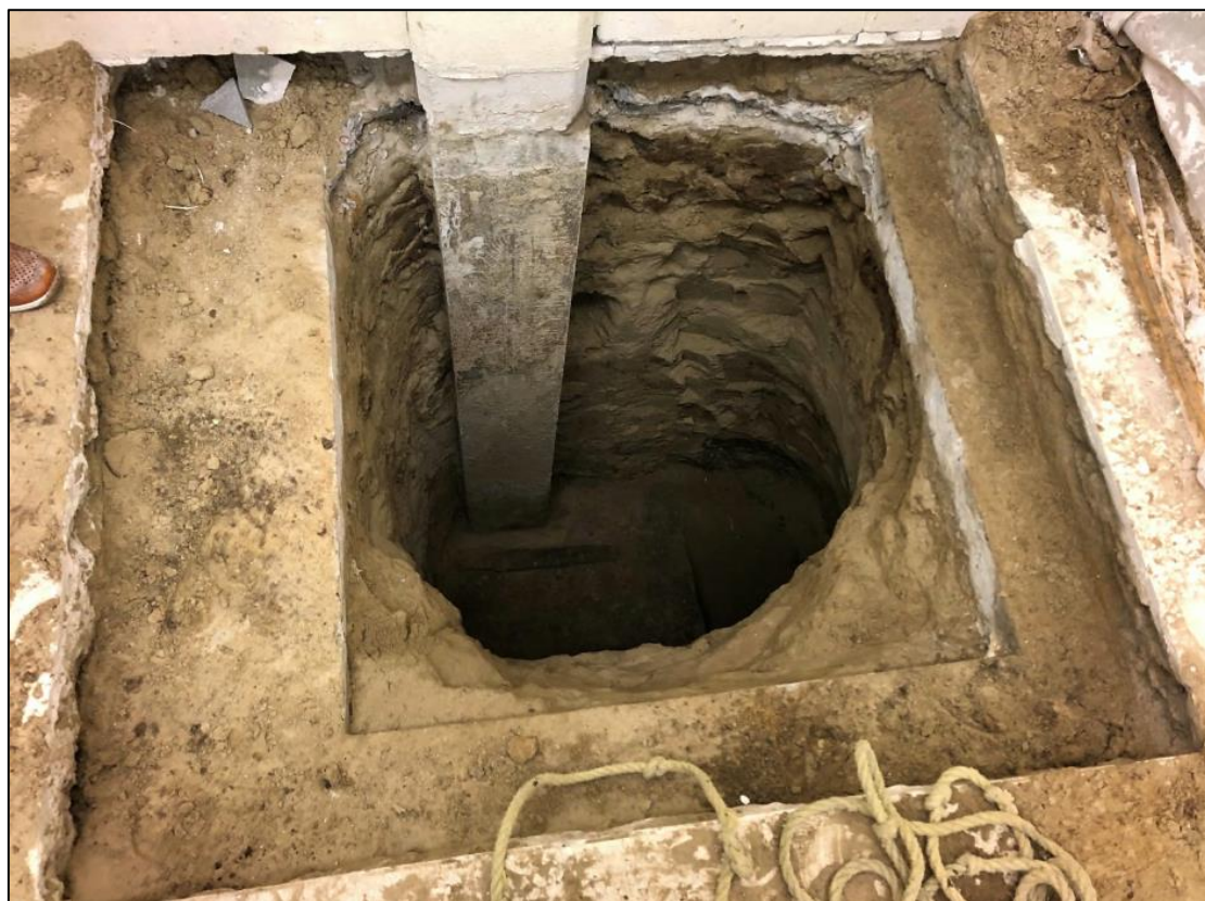
Figuur 8: Foto van een huidige funderingszool met zicht op de betonplaat tijdens funderingsonderzoek (AAVO 2021)
