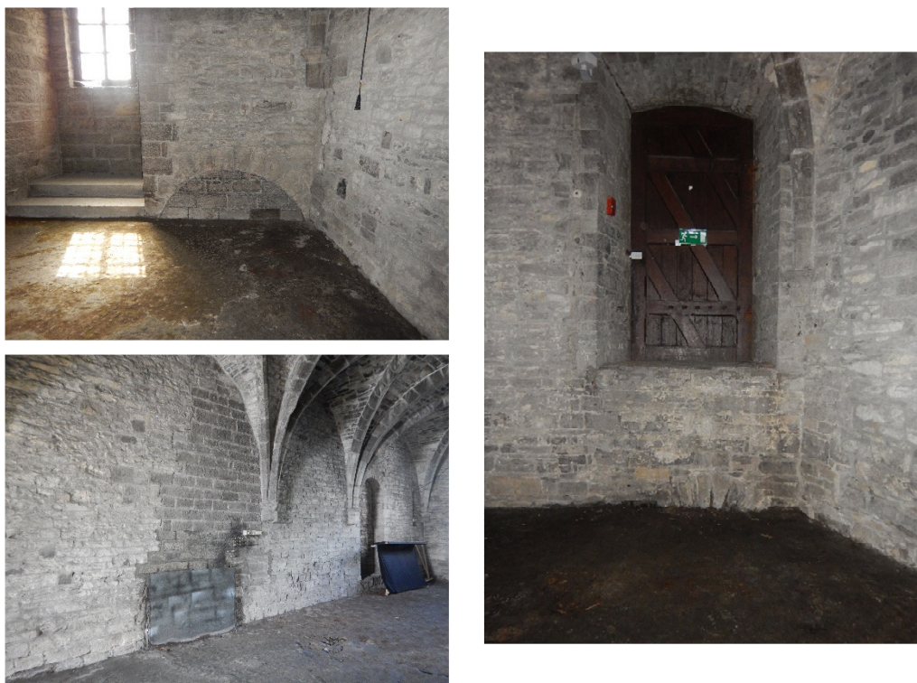
Figuur 9. In wijzerszin: een dichtgemetselde watertrap in de zuidoostelijke hoek van de crypte; een obsolete toegang in de noordwestelijke hoek; verschillende herstelwerken in de zuidwestelijke hoek nabij de toren.
