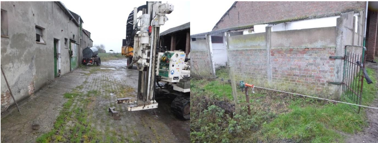
Figuur 44: Omgevingsfoto ter hoogte van boringen BP3 (links) en BP1 (rechts).
