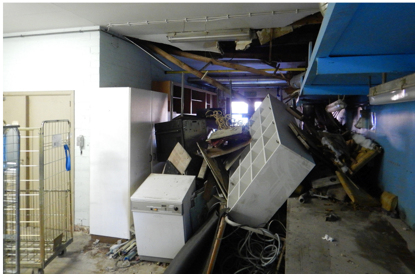
Figuur 7. Zicht op de wasserij, het laatste relict van het oudere gebouwenbestand. Onder: ingestorte dakstructuur naast de eigenlijke werkplek.
