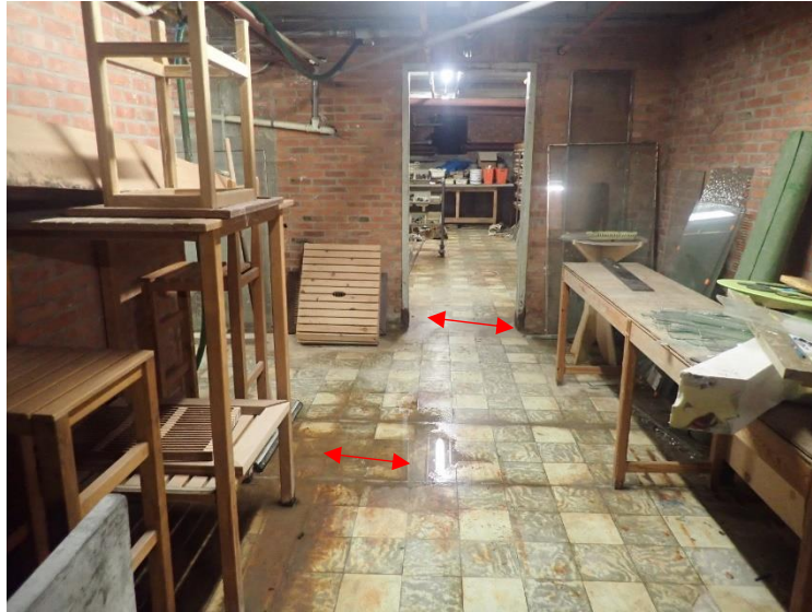
Fig. 70: roest en water in de kelder van gebouw F
