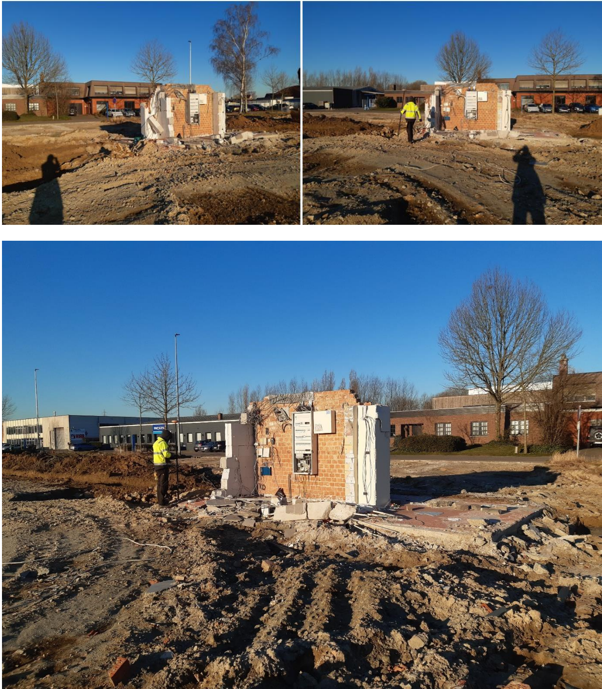
Figuur 25: Enkele foto's van de deels gesloopte elektriciteitscabine (© J. Verrijckt bvba.).
