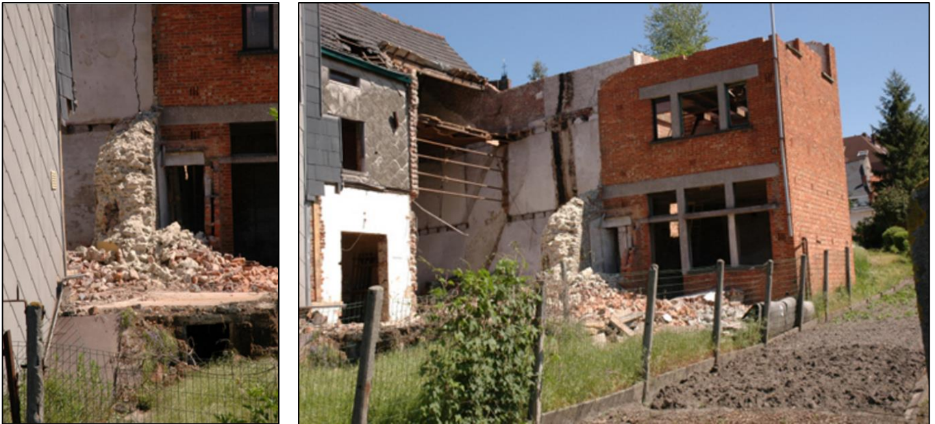
Figuur 29: Foto's van afgebroken muur (bron: radio MIG 2008)
